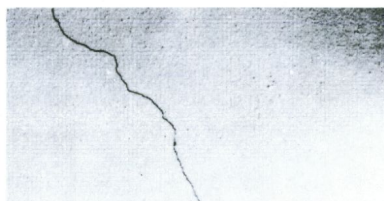
Schubriss in Innenwand, von innen-oben nach unten-aussen.
