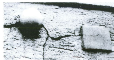
Fassaden-Eckriss, Decke abgehoben, mit Längenänderungen der Decke.
